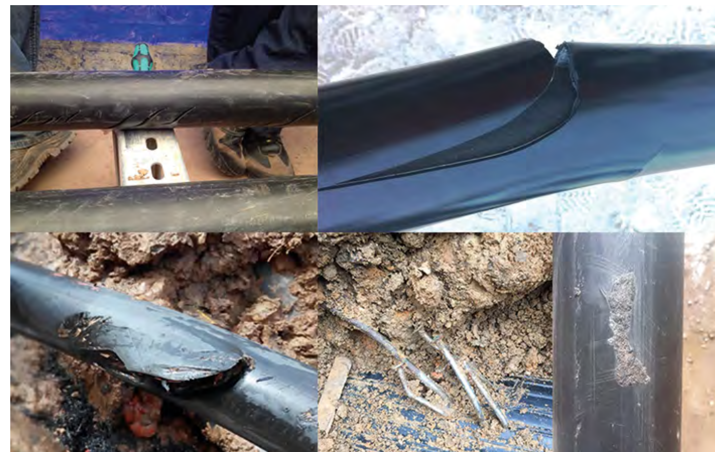
Фото 1. Повреждения кабелей при прокладке и монтаже
