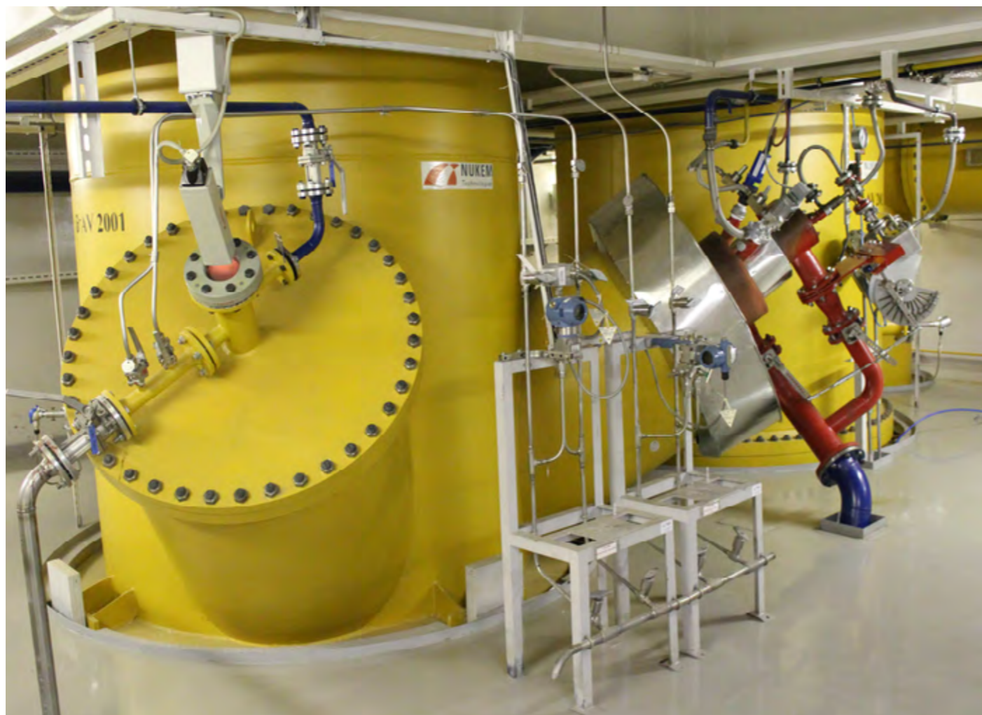
Ленинградская АЭС. Комплекс по переработке и утилизации твердых радиоактивных отходов (ТРО) на ЛАЭС.
